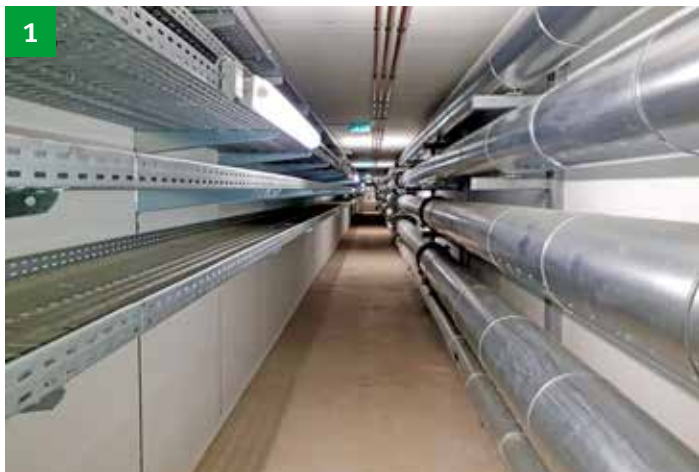
Beispiel eines Leitungskanals im Betrieb
