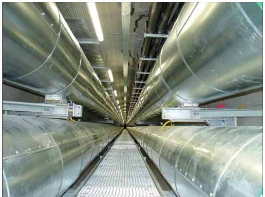
Versorgungskanal, vorrangig für Fernwärmeleitungen und weitere Medien
